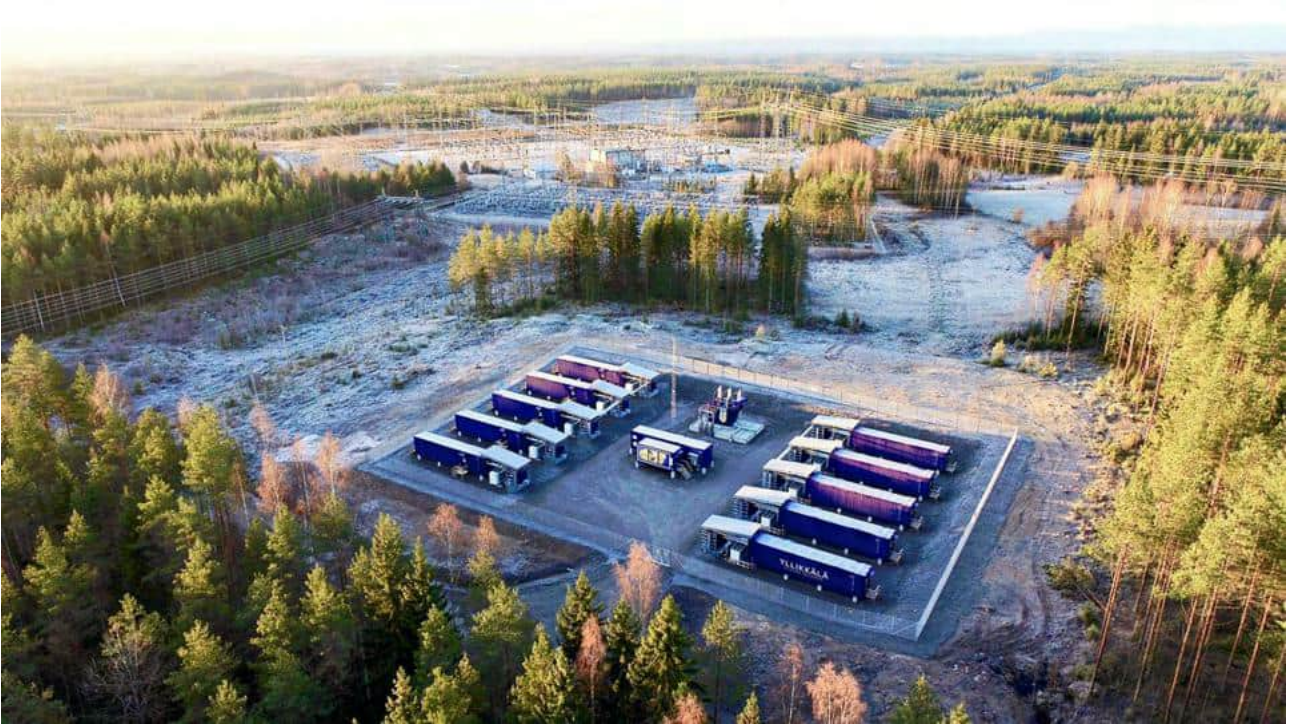
Kuva 9. Esimerkkikuva akkuvarastosta, Neoenin akkuvarasto Ylikkälässä Etelä-Karjalassa (Lähde: Fingrid)
