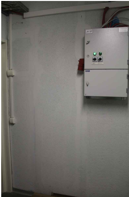
Verkkoinvertterin asennuspaikka sähkökeskuksessa.
