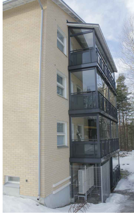
Tasavirtakaapelointi panelistolta verkkoinverterille onnistuu putkitettuna parvekkeiden vierustaa pitkin.
