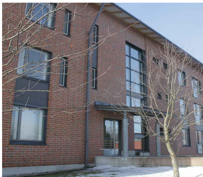
Tasavirtakaapelointi katolta invertterille onnistuu kätevästi syöksyputken vierestä.
