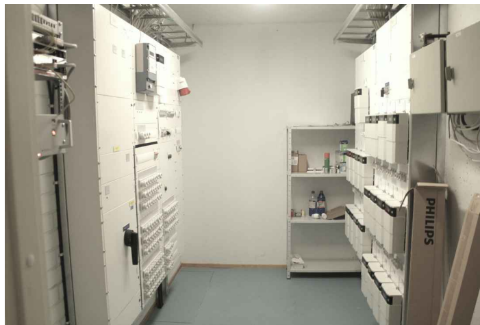
Sähkökeskuksessa on hyvin tilaa invertterille.
